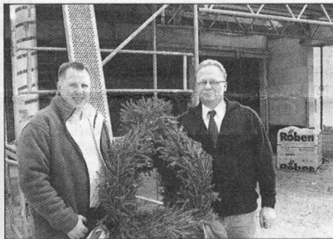
Bauherr Olaf Weber (li.) und „Mieter“ Hillmar Cordes (Penny-Gebietsleiter Expansion) vor dem Rohbau des Discounters in Hollenstedt Foto: bc
